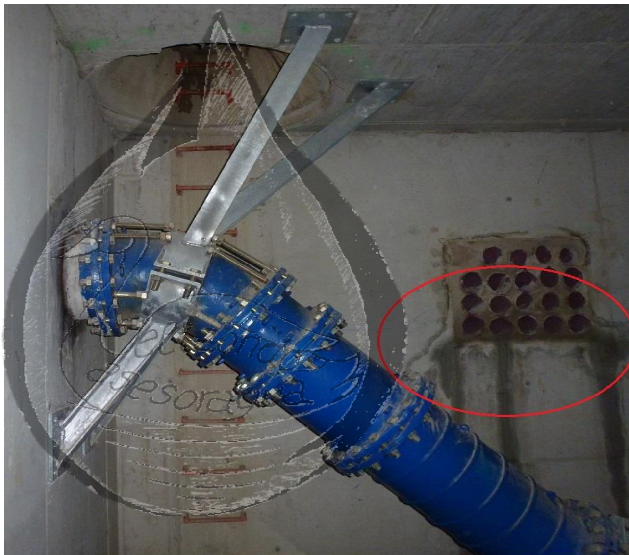
ENTRADA AGUA A GALERÍAS POR CONDUCTOS SERVICIOS Y ACOMETIDAS SNTU URBANIZACIÓN (AFECCIONES INTERNAS)
