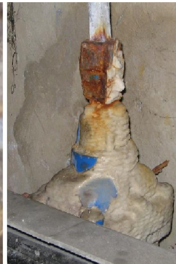
AFECCIONES POR MALAS CONDICIONES INSTALACIÓN
