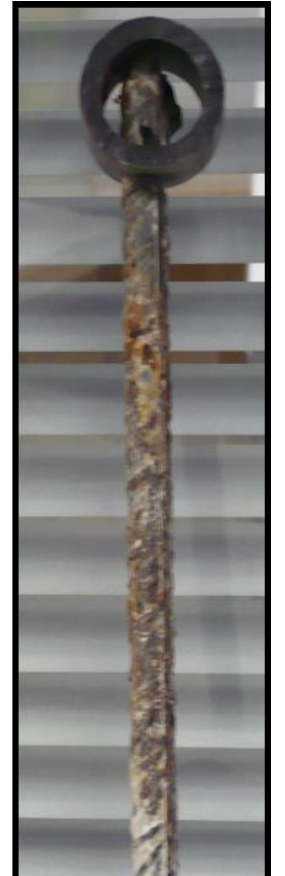
AFECCIÓN EN ACOMETIDA
