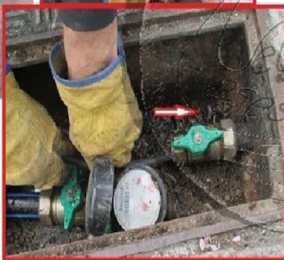
Ubicación acometida congelada, soltar contador, e introducción manguera de la hidrolavadora con la piña de eyección en punta
