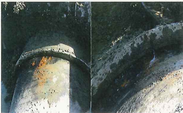
FIGURA 11. Existen goteos, en instalaciones enterradas, imposibles de detectar con los sistemas convencionales.
