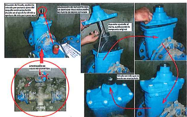
FIGURA 6. Uso de casquillos antimanipulación en las válvulas de compuerta de las redes de agua.
