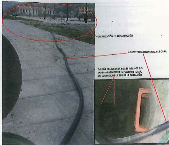
FIGURA 4. Uso fraudulento de agua en obra de urbanización.
