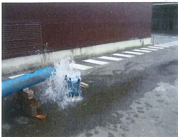
FIGURA 4. Desplazamiento con tubería purgada en inicio.
