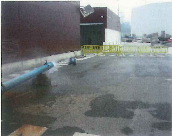
FIGURA 3. Desplazamiento final del tapón de la tubería, sin contrarresto.
