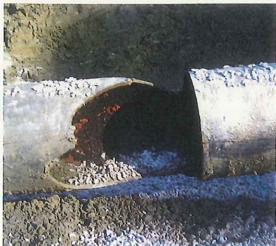
FIGURA 6. Rotura de la tubería por efecto del golpe de ariete.
